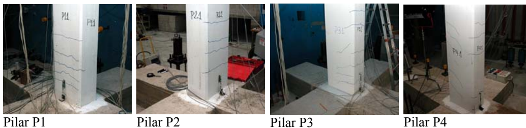
Figura 5: Fendilhação na base dos pilares
